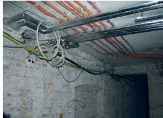
Seit sieben Jahren wartet die Schule vergeblich auf die Fortsetzung der Sanierungsarbeiten.
