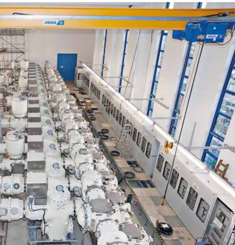
Schaltanlage aus einem Netzknoten, das heißt von einem Verteilerpunkt für die 110-kV-Kabelsysteme
